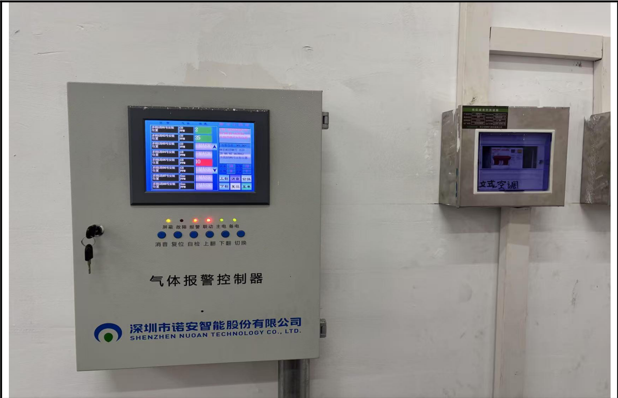
图 2.8-2 气体报警控制器现场照片
